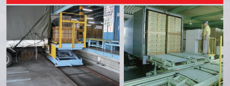
パレット用トラック積み込み用シザーリフト
